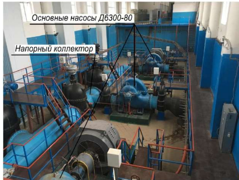
Рисунок 3.1 – Общий вид машинного зала насосной станции «Междуречье»
