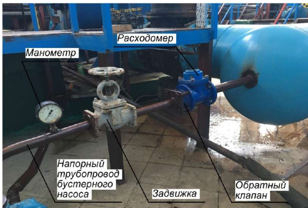
Рисунок 3.8 – Манометр для определения потенциальной энергии бустерного насоса в напорном трубопроводе
