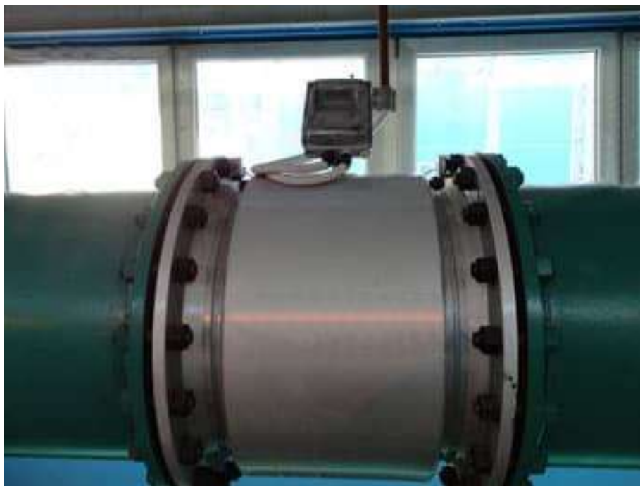
Рисунок 3.10 – Электромагнитный расходомер для определения расхода в напорном магистральном трубопроводе (EUROMAG MUT2500EL)
