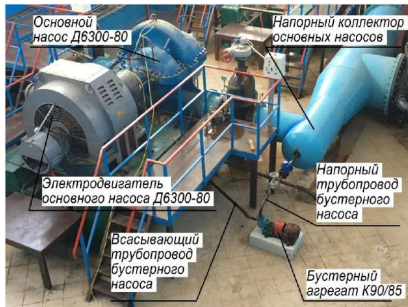
Рисунок 3.2 – Внутренний вид обвязки бустерного агрегата, установленного на насосной станции «Междуречье»
