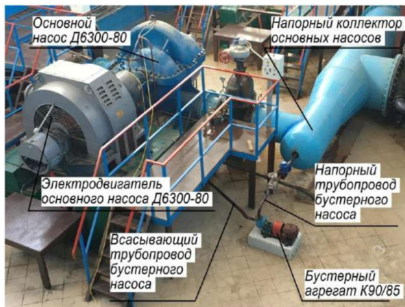
Рисунок 2 – Внутренний вид обвязки бустерного агрегата, установленного на насосной станции «Междуречье»
